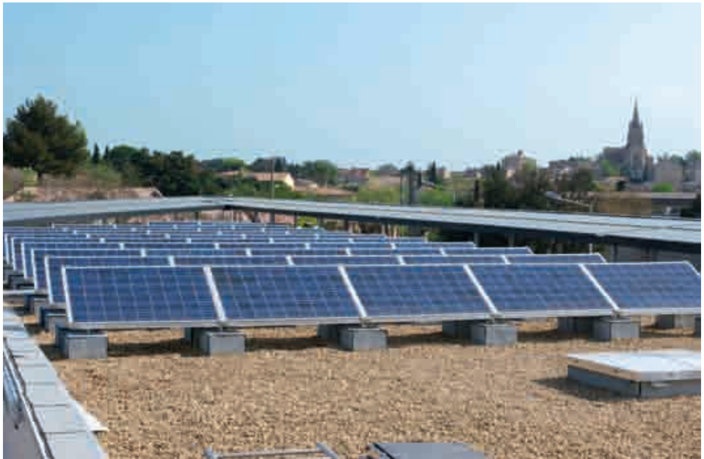
View of the photovoltaic cells in the multimedia library of Castries roof. Installation photovoltaïque de la médiathèque d'Agglomération Françoise Giroud. Vista de las celdas fotovoltaicas en el techo de la biblioteca multimedia de Castries.
